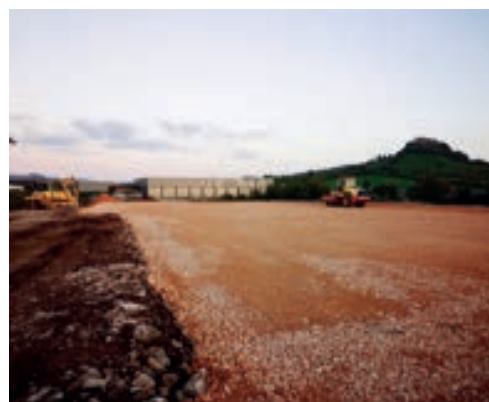
ZAE du Marteliez, tranche 4, chantier de l'entreprise « OXETI », photo A. Laussel (entreprise Oxeti)
